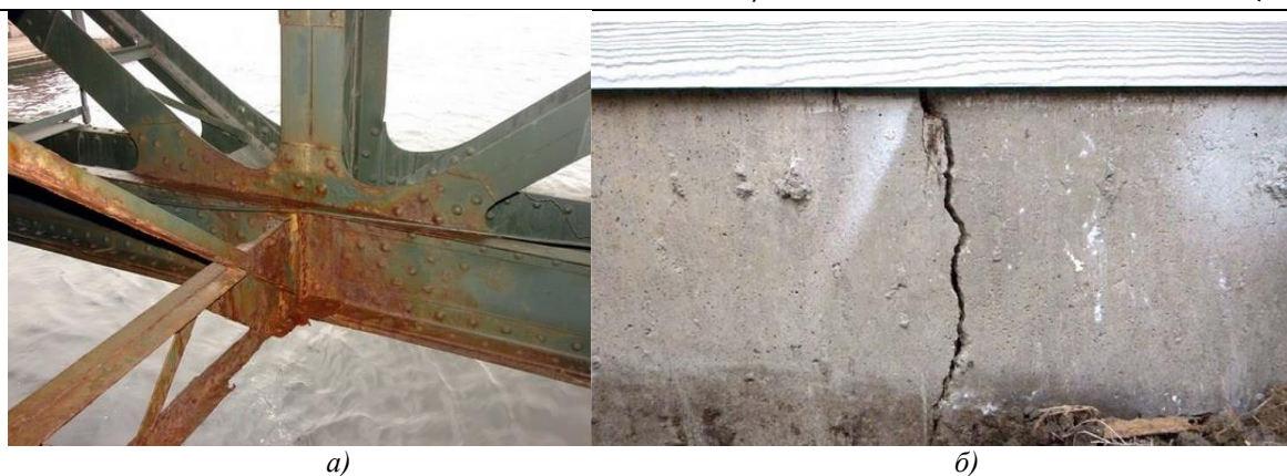
Рисунок 1 – Примеры дефектов конструкций (а – коррозия металла; б – трещина в бетоне)
