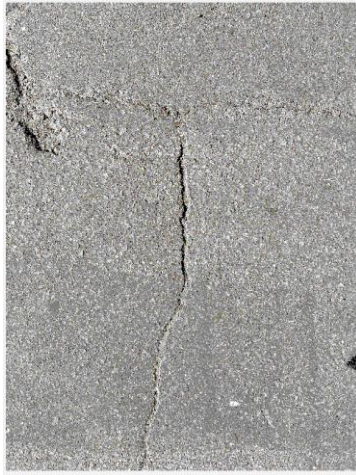
Рисунок 1 - Исходное изображение дефекта (трещина)
